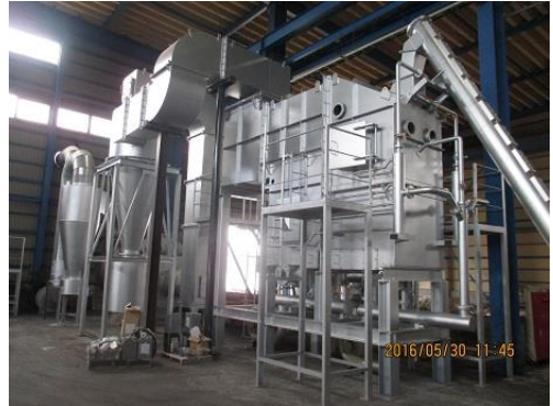
蒸気ボイラーシステム
